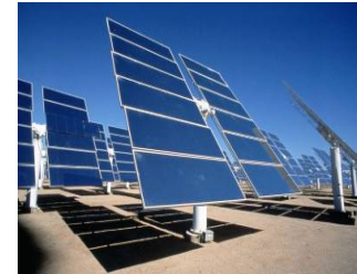
태양광 발전 (박막 태양전지)
